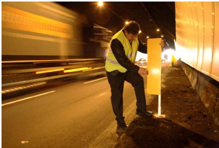
Ispettore in azione all'interno del tunnel Serra Rotonda Il delineatore in evidenza (peraltro previsto dalla normativa italiana) impedisce la transitabilità del marciapiede
