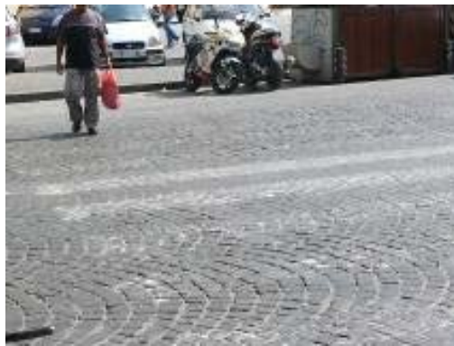
Condizioni di manutenzione del peggiore attraversamento testato a Napoli (n. 8 via San Carlo angolo piazza Trieste e Trento)
